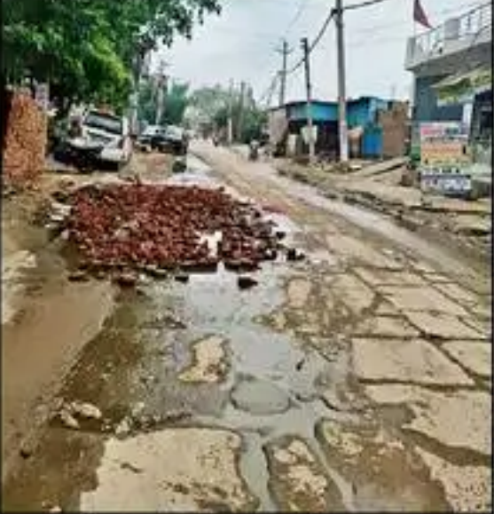
पृथला औद्योगिक क्षेत्र की जर्जर सड़क।
